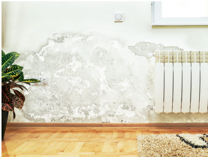
Bei grösserem Schimmelpilzbefall müssen die Ursachen abgeklärt werden. Dann gilt es, rasch zu handeln.
